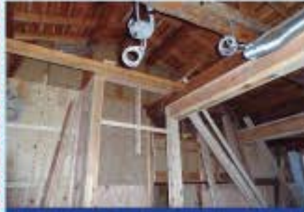
快適空間を支えるものはあくまでも、構造体です。表面のお化粧が上手でも、メッキが剥ければ、「はい、それまでよ」
